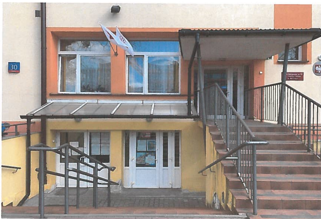
Widok wejścia/wyjścia głównego do/z budynku Szkoły, z klatki schodowej K1 - wyjścia na poziomie parteru i poziomie piwnicy
